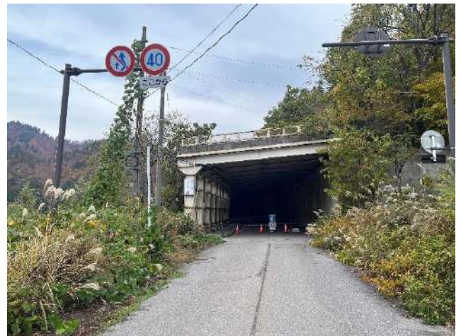
11:01 R252 スノーシェットの廃道
